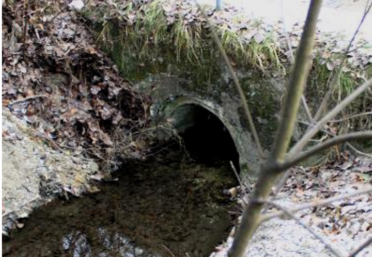
Abbildung 3-7: Sedimentablagerung in einem Durchlass
