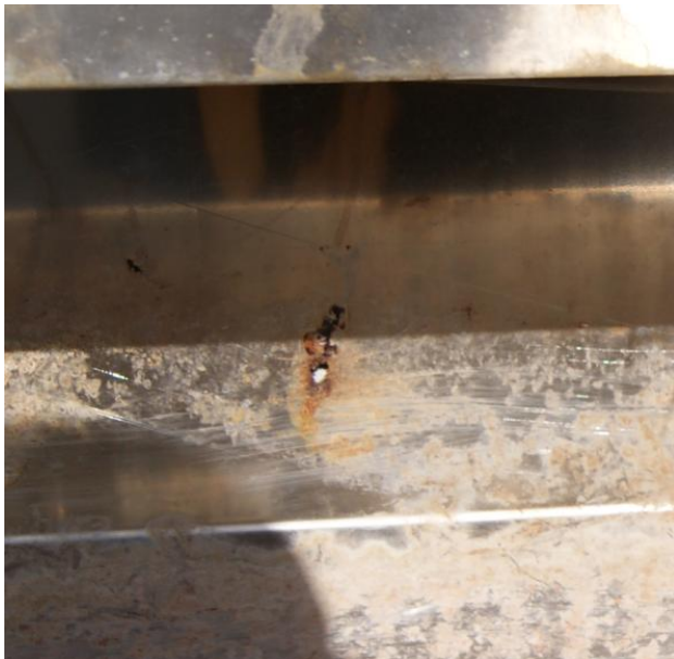
Abbildung 5: Fortgeschrittene Lochkorrosion (selbsterstellt)
