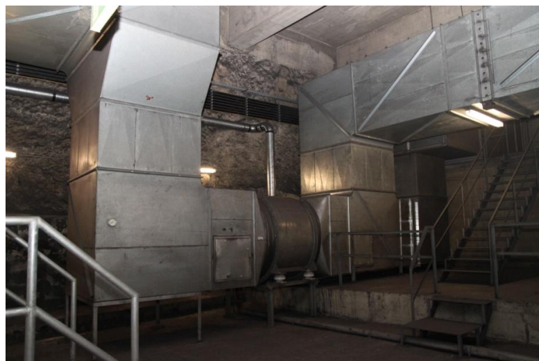
Abbildung 7: Stahlblech-Lüftungskanäle der Brandrauchentlüftung
