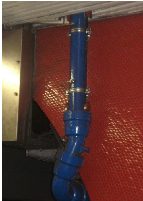
Abbildung 8: Trockenlöschleitung am Bahnsteig der Station Karlsplatz
