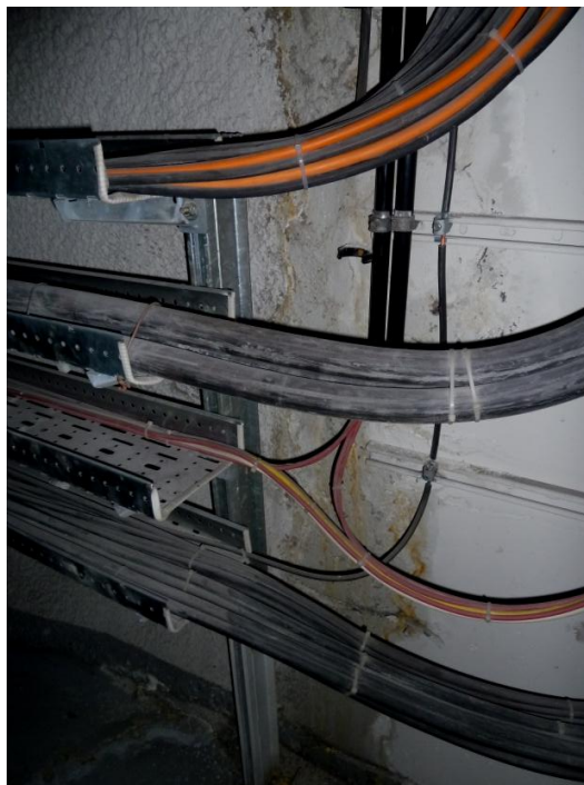
Abbildung 5: Kabel der Mittelspannungsanlagen
