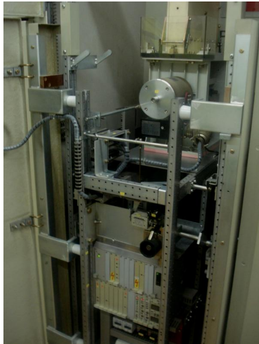
Abbildung 6: Innenleben eines Schaltkastens
