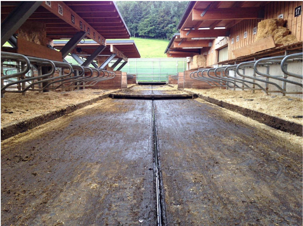
Abbildung 12: Kombischieber im Außenbereich des Rinderforschungsstalles.
