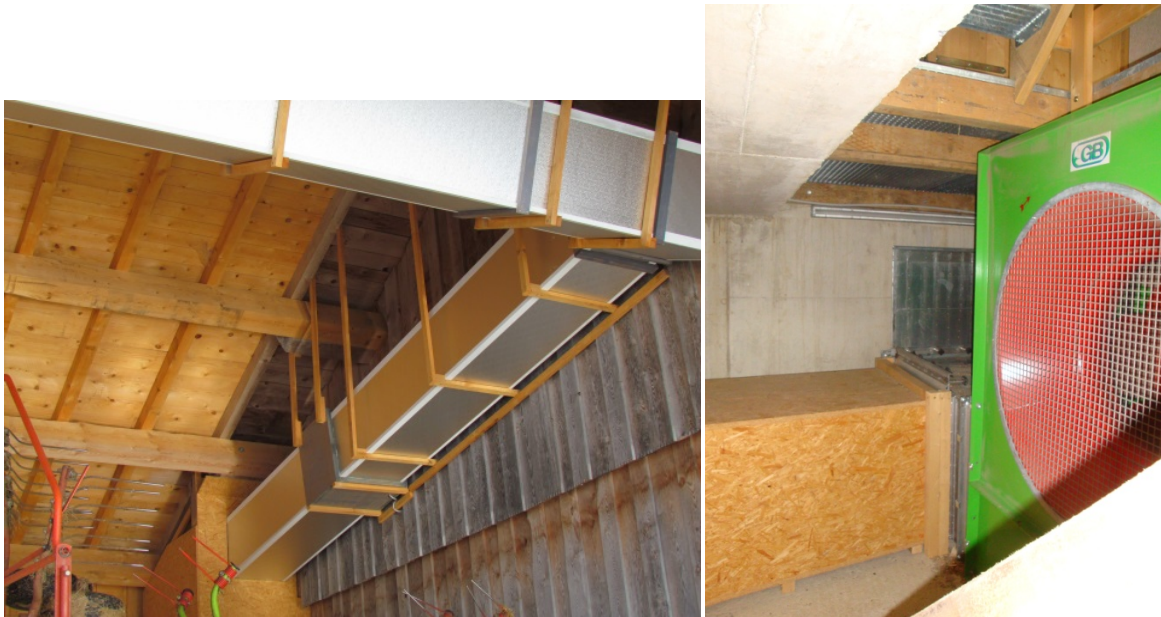
Abbildung 8: Transport der erwärmten Luft durch isolierte Luftschächte (links) bis zur Mischbox. Dort erfolgt die Vermischung mit der Außenluft und das Einblasen mit Hilfe der Ventilatoren (rechts) in die Trocknungsbox.
