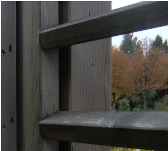
Abbildung 063: Beginnende Verwitterung am Stoß zwischen Lamellen und Rahmen. Schadhafte Lackierung.
