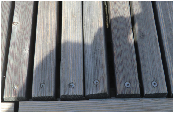
Abbildung 038: Unzureichende Verschraubung zu schmaler Deckbretter
