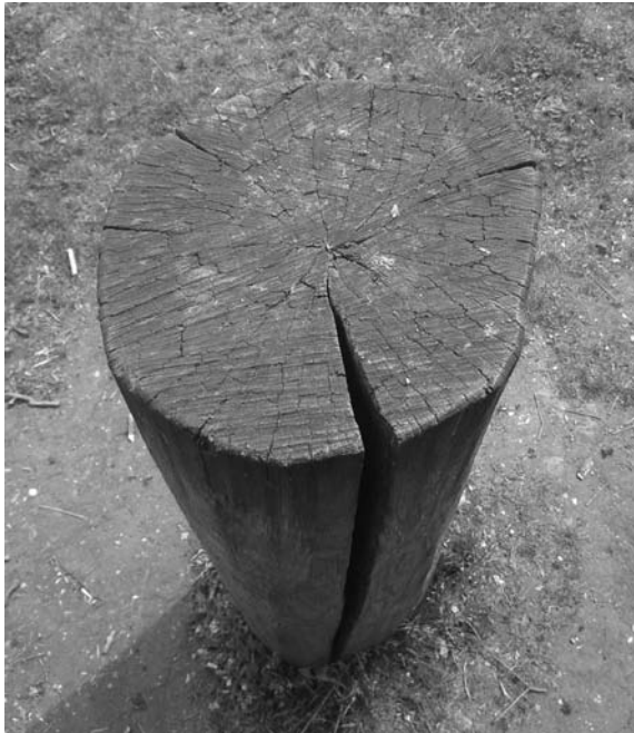
Abbildung 010: Rissbildung bei Rundholz mit Erdkontakt
