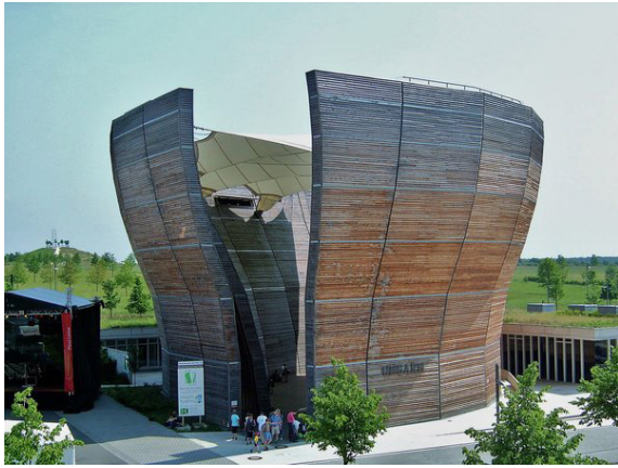
Abbildung 011: Holzverfärbungen durch Bläuepilze am ungarischen Pavillon der Expo 2000 in Hannover (Bild von 2006)
