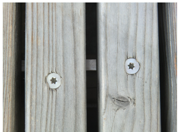
Abbildung 041: Ausrisse im Holz im Bereich der Schrauben
