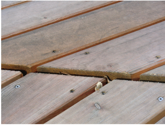
Abbildung 075: Stolperfalle am Anschluss zweier Holzebenen
