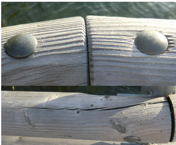
Abbildung 048: Zu kleine Fugen zwischen den Rundhölzern
