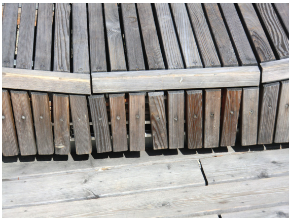
Abbildung 039: Unzureichende Verschraubung einiger der kurzen vertikal stehenden Bretter
