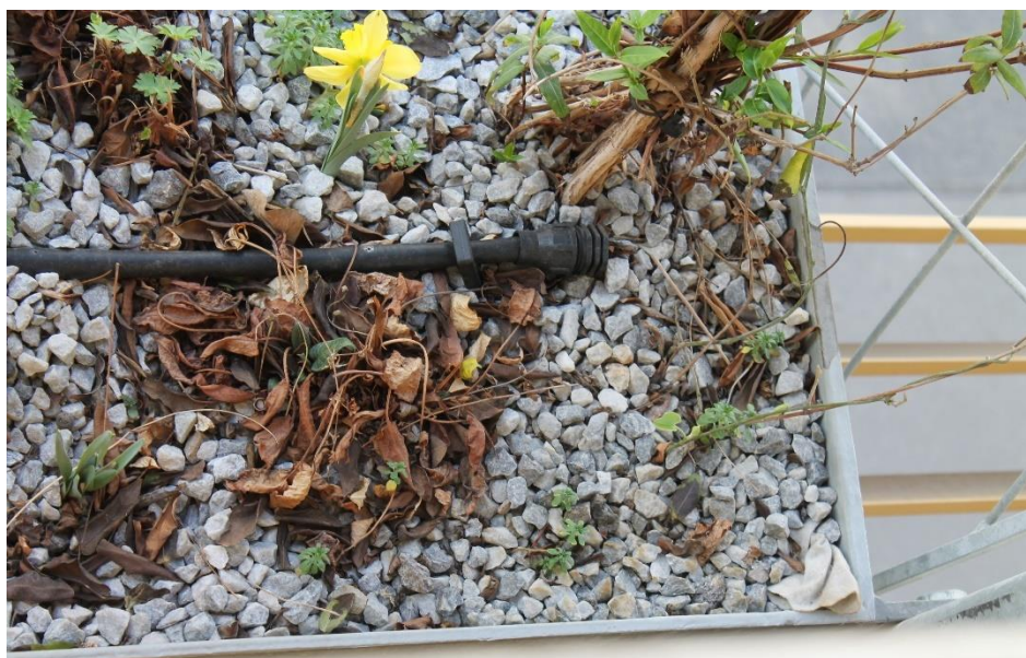
Abb. 28: Detail Tropfschlauch (Quelle: eigene Erstellung 2018)
