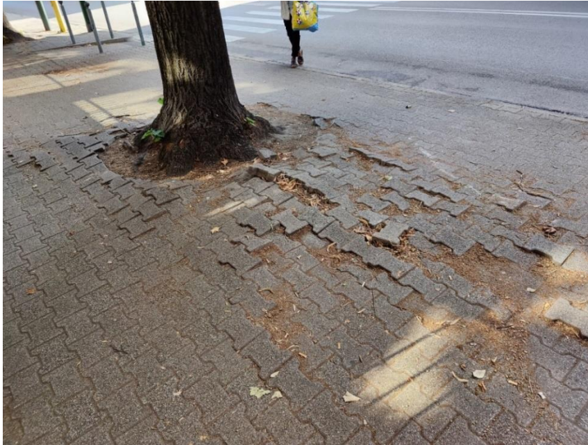
Abbildung 5: Schäden an Pflasterungen durch Baumwurzeln
