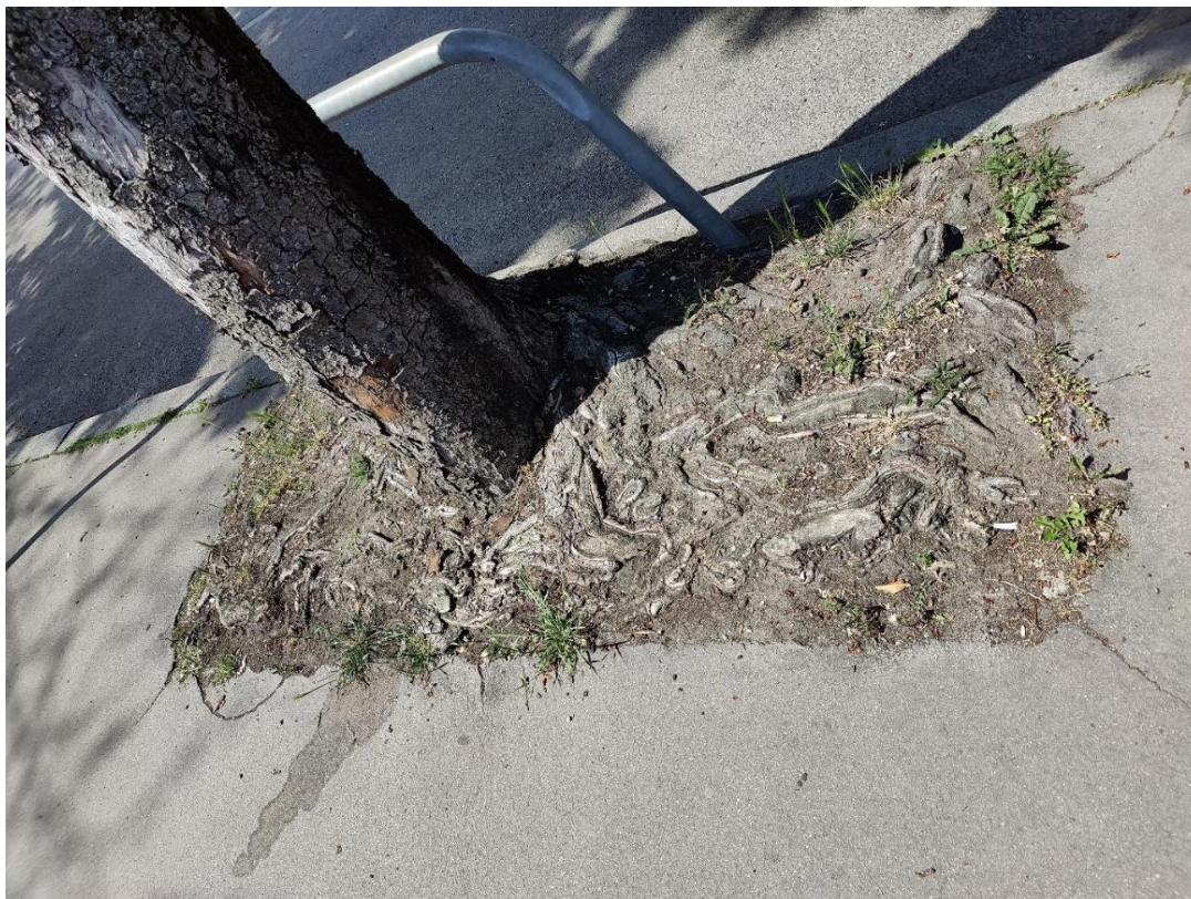
Abbildung 3: Begrenzter Wurzelraum eines Straßenbaums in Wien
