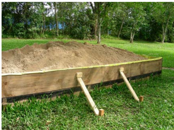
Abb. 62: Stützelemente der Holzkonstruktion (Versuch Einlagewinkel in Sand mit Phyllanthus sellowianus , Santa Maria / UFSM, Okt. 2008)
