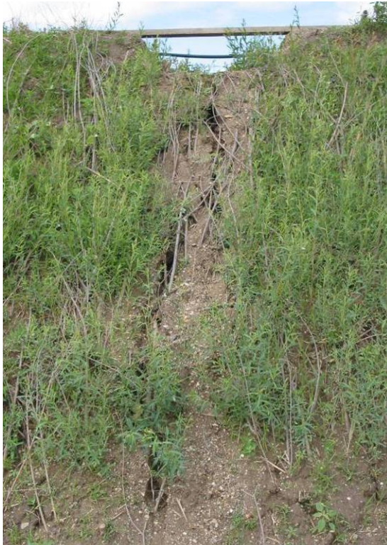
Abbildung 93: Schäden der Weidenspreitlage längs, Sektor 9 (Deutsch-Wagram, LAMMERANNER Juni 2007).
