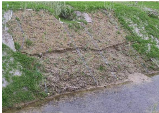
Abbildung 85: Schäden am Sektor 6 nach Unwetter (Deutsch-Wagram, LAMMERANNER September 2007).
