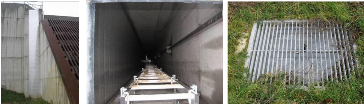
Abbildung 99: links und Mitte: Bypass aus Dammbalken mit Schieberschacht, rechts: Fallklappen (Seilzug)
