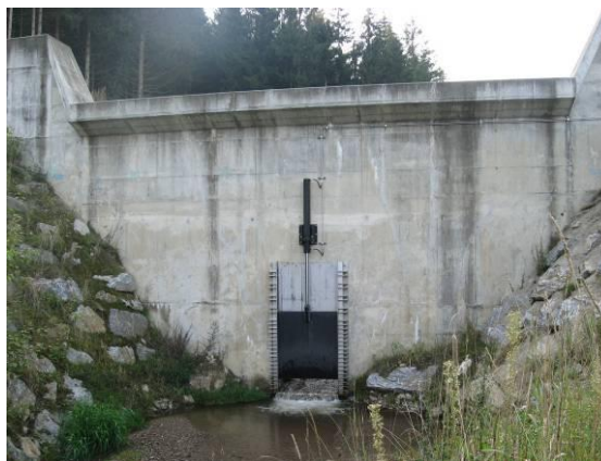
Abbildung 95: maschinell verstellbarer Gleitschütz von sicherem Standplatz aus
