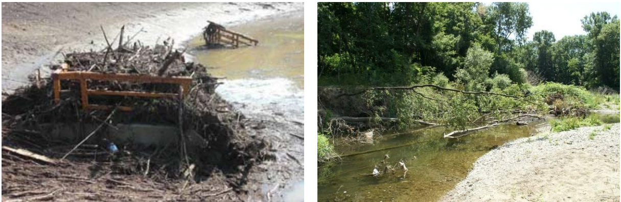
Abbildung 66: links: Verklauster Grundablass nach HW, rechts: Totholz als Strukturelement
