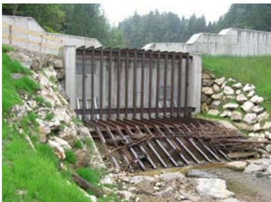
Abbildung 69: Gebrochener Rechen - Aufgleiten und Ablegen des Schwemmholzes
