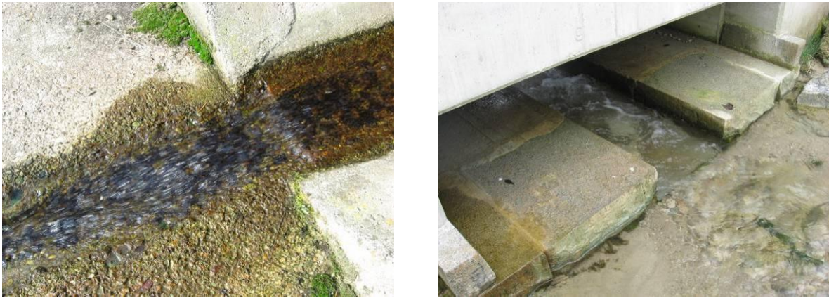
Abbildung 32: links: Materialabrieb des Durchlass- und Auslaufbauwerkes (Hydroabrasion), rechts: mit Granitstein gepanzerter Durchlass
