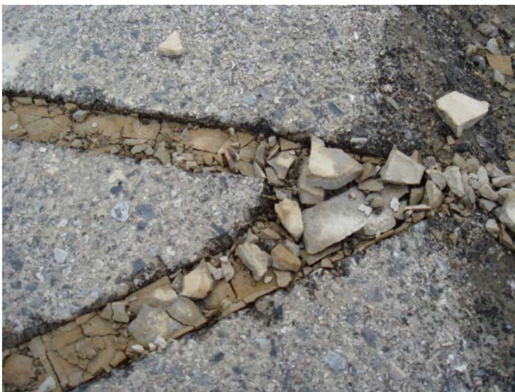
Abbildung 1.18: Zählstelle Klosterneuburg, Frostschäden an der Verfüllung mit Blitzzement nach Winter 2007/08
