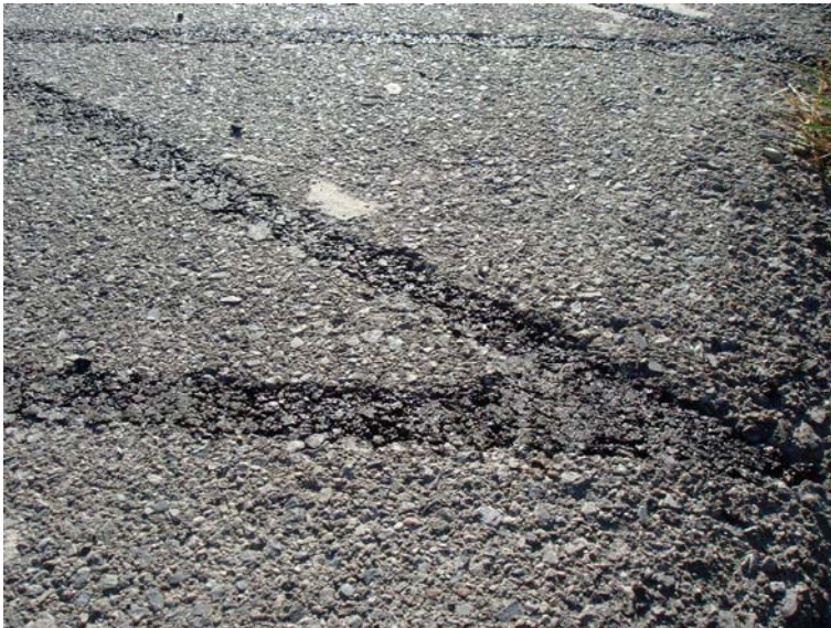
Abbildung 1.19: Zählstelle Klosterneuburg, Erneuerung der Verfüllung mit Kaltasphalt nach Frostschäden an ursprünglicher Verfüllung mit Blitzzement nach Winter 2007/08
