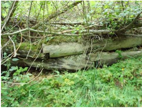
Abbildung 6060: Durch starken Hangdruck hat der Sperrenkörper Nr. 8 an den Überblattungen nachgegeben, Wötzelgraben Matsch, 08/2010
