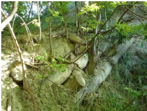
Abbildung 8181: Von Abbruch beeinträchtigte linke Schulter, Schlossgraben Matsch, 08/2010
