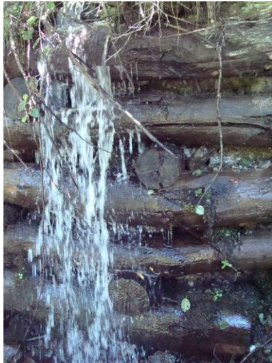
Abbildung 8989: Die Verformung der Längshölzer lässt starken Hangdruck vermuten, Seitengraben Pitzbach Rojen, 09/2010
