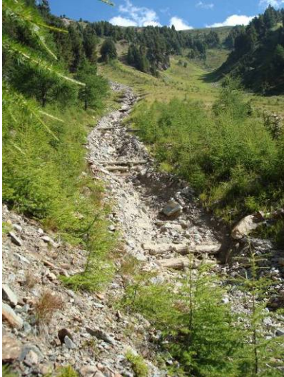
Abbildung 4848: Lärchensperren im südlichen Kompatschgraben, Kompatschgraben Plawenn, 08/2010
