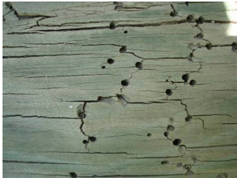
Abbildung 5353: Detail Insektenbefall Sperrenkörper, Kompatschgraben Plawenn, 08/2010
