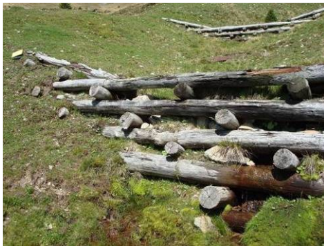
Abbildung 6868: Das Holz der Sperre ist optisch beurteilt in mäßigem Zustand, die Steinverfüllung ist ausgewaschen; Innerer Kuhleitengraben, 08/2010
