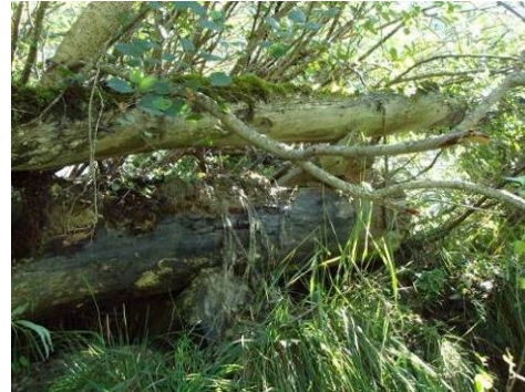
Abbildung 9090: Linke Schulter an der Außenkante nur noch durch Baustahlklammer zusammengehalten, Seitengraben Pitzbach Rojen, 09/2010
