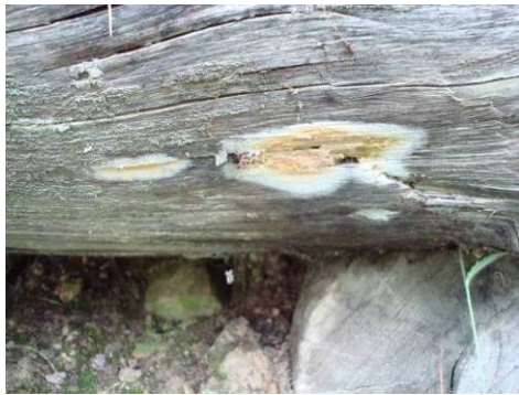
Abbildung 5959: Beginnender Pilzbefall am Sperrenkörper Nr. 6, Wötzelgraben Matsch, 08/2010
