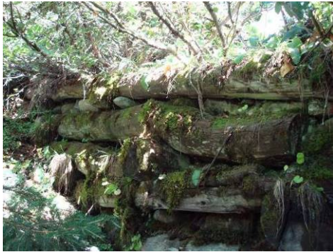
Abbildung 8787: Schultern wurden lediglich an der Oberkante mit Grünerle bepflanzt, Seitengraben Pitzbach Rojen, 09/2010
