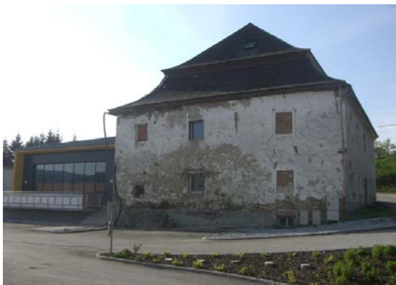
Abbildung 36: Leerstand Stifterstraße 12, Gebäudeansicht von Norden (Quelle: Eigene Aufnahme am 04. 05. 2012)
