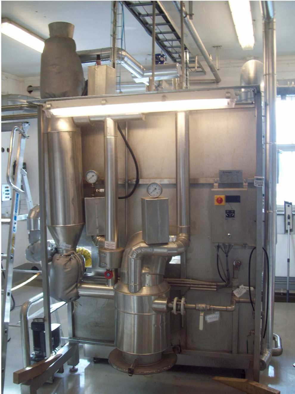
Abbildung 11: Ansicht der für die Vorbehandlungen verwendeten SE Laboranlage der Fa. CAMBI in As
